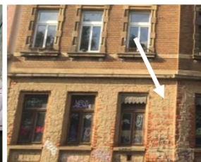
sehr ungepflegt, umfassen- der Erneuerungsbedarf Beispiel Fassade
